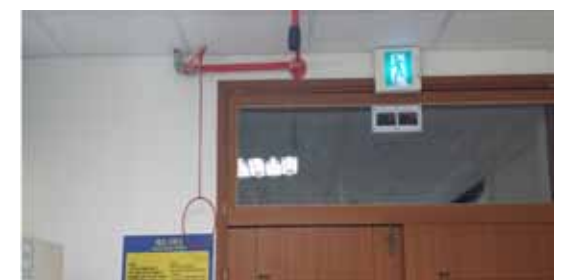
출입문 비상사위 시설
