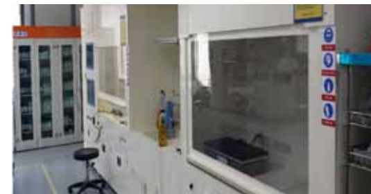
Inverter적용 법정 후드풍속 유지(0.4m/s)
